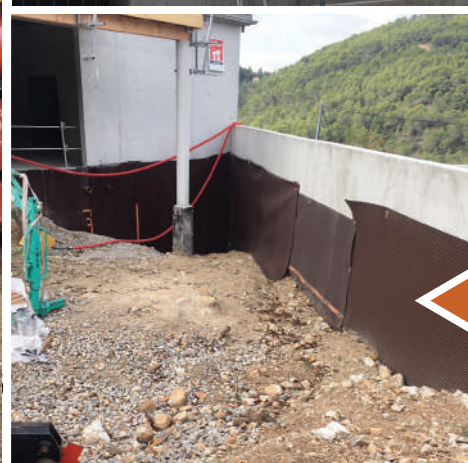
Emplacement de la future citerne de récupération des eaux de pluie de 30m 2
